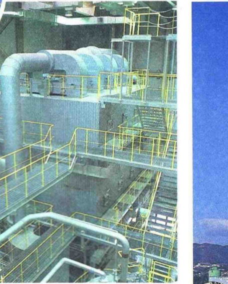
有害ガス除去装置およびバグフィルタ 排ガスに含まれている塩化水素や硫酸酸化物は、粉状の消石灰と反応させて除去されます。また、ばいじん(すすやホコリなどの微粒子)は、バグフィルタのガラス繊維質のろ布によりろ過、除去されます。
