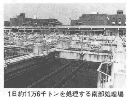
1日約11万6千トン処理する南部処理場
