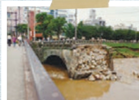
8・6水害 (流失した武之橋)
